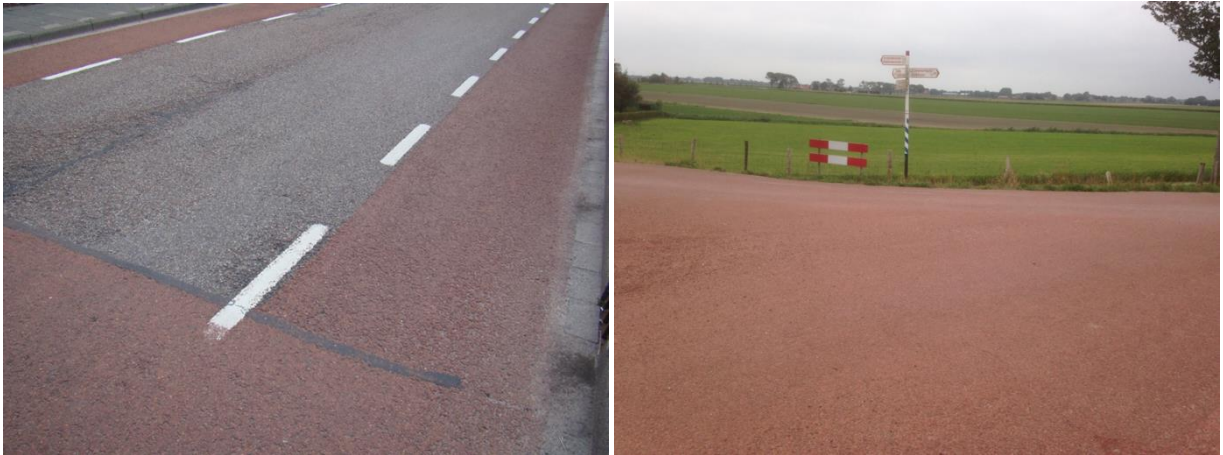
Afbeelding 4 en 5: Typisch schadebeeld van rood asfalt met niet gemodificeerd kleurloos bindmiddel. Datum van aanleg voor de situatie links was rond 2004. Hier was in 2019 duidelijk rafeling zichtbaar, maar dit gold ook voor het tussenliggende (zwarte) asfalt.
