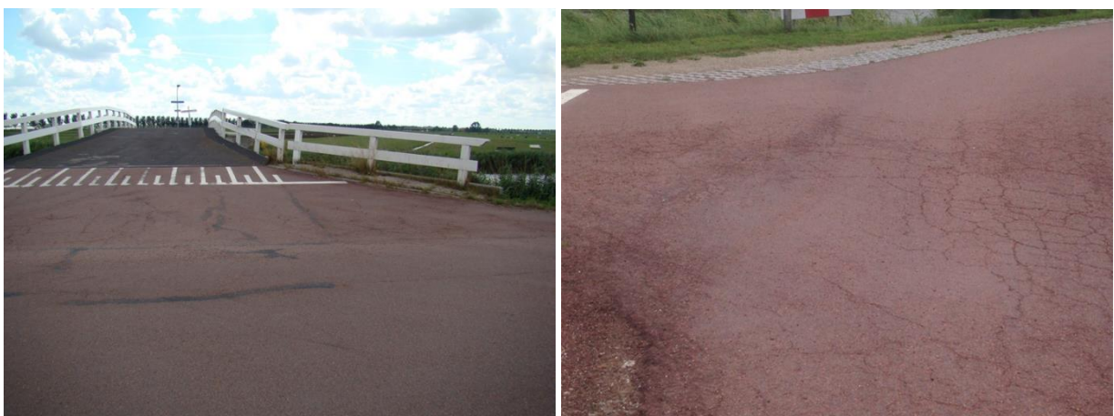
Afbeelding 2 en 3: Typisch schadebeeld van rood asfalt met zwarte bitumen. Datum van aanleg is niet bekend, maar vermoedelijk minder dan 10 jaar geleden.
