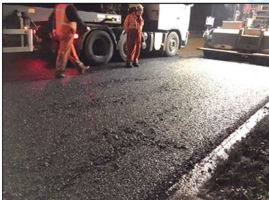
Figuur 1. Slecht verwerkbaar PMB-asfaltmengsel
