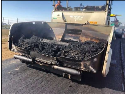
Figuur 3. Onverwerkbaar asfaltmengsel
