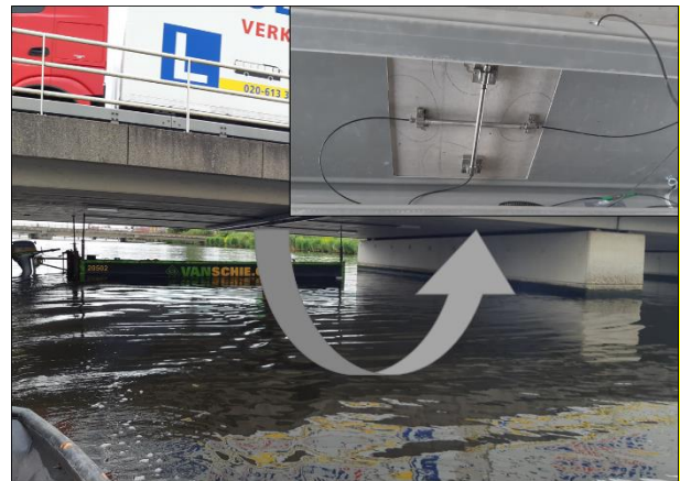
Figuur 3: Het WIM-BRIDGE systeem zoals deze op de Noord brug is geïnstalleerd onder de 3 e overspanning in de rijrichting. De fiber-optische reksensoren (rechts boven) zijn in het midden van de brug gemonteerd op \frac{1}{2} L van de overspanning voor een maximaal effect. Op \frac{1}{4} L en \frac{3}{4} L zijn extra lengte sensoren per rijstrook geplaatst voor de snelheidsbepaling.
